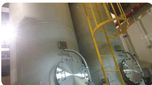
고양 바이오매스 에너지사업 시설 내 탈황설비(1,264m 3 /hr)
